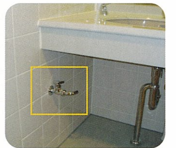
トイレの清掃用蛇口
